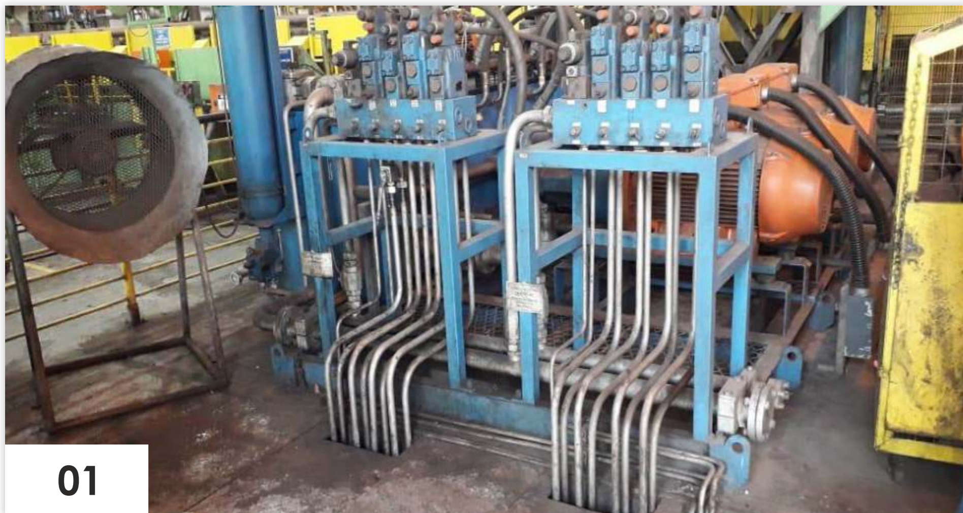
PAINEL HIDRÁULICO (Us1 E Us2) - ANTES
