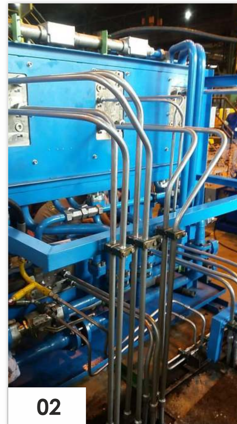
PAINEL HIDRÁULICO (Us1 E Us2) DEPOIS - NOVO
